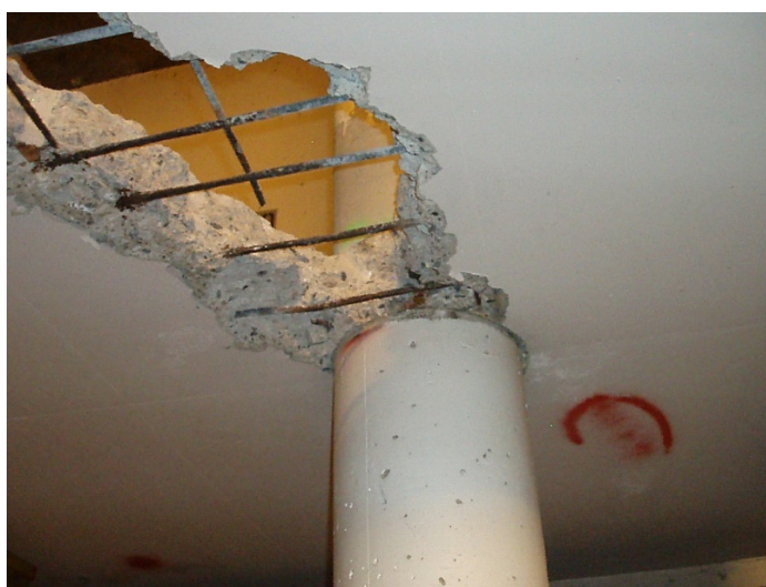
Skader i dekke sett fra nedre plan
