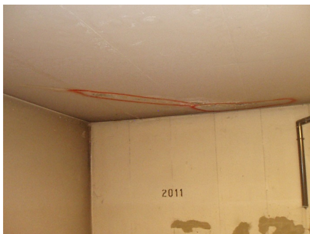
Delaminering av dekke over parkering 2011
