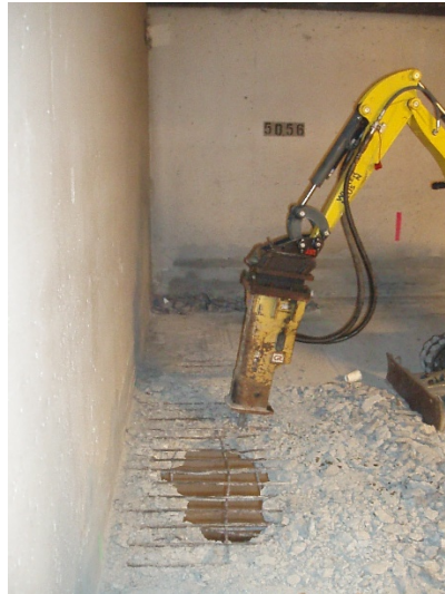
I dette området er noe armering sterkt skadet
