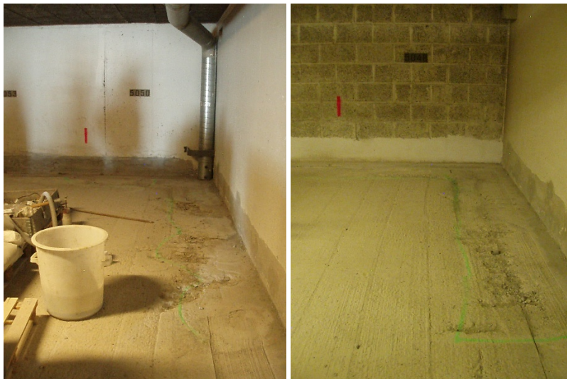
Noen av områdene hvor skadeomfang ikke er avdekket
