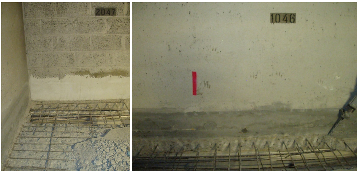
Områder med skadet armering
