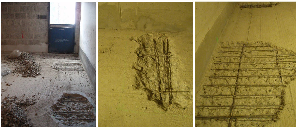
Typiske områder med bom(hulrom) i betong hvor armeringen er inntakt
