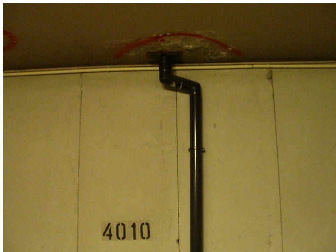
Typisk skade ved sluk/nedløpsrør
