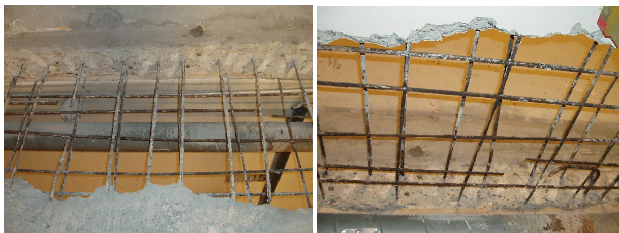
Nærbilder av skadet betong ved parkeringsplass 1046
