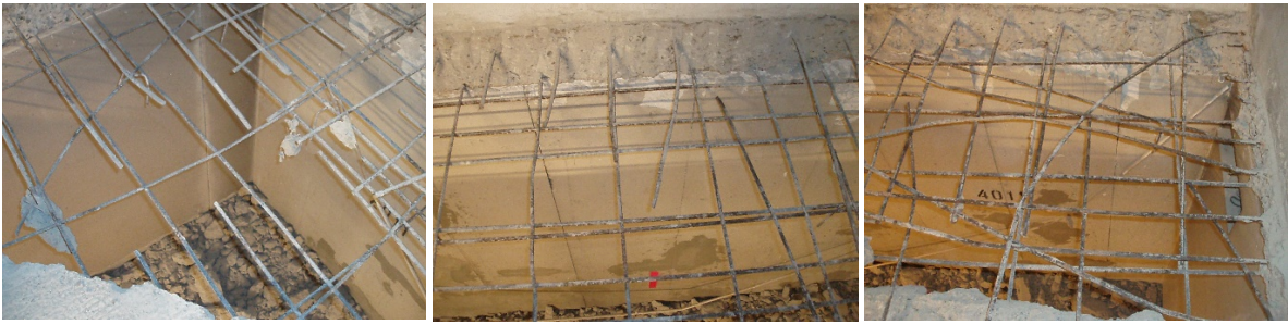
Områder med store armeringskader
