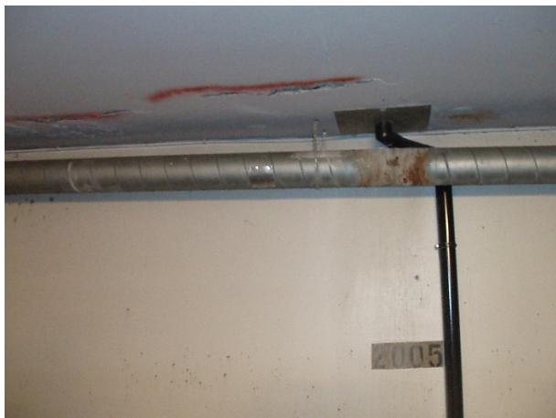
Delaminering av dekke over parkering 2005
