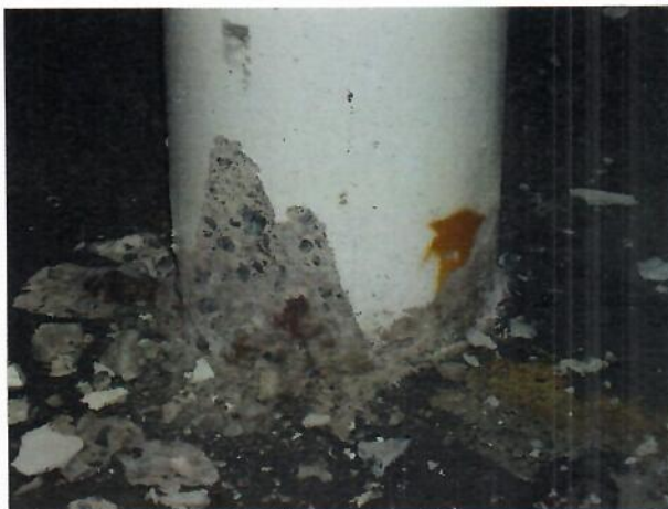
Søyle med skader
