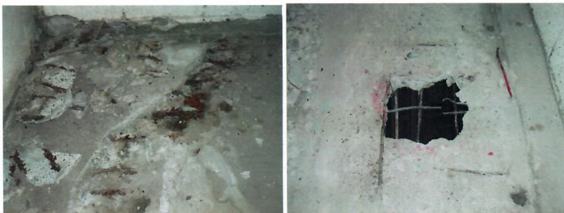
Skader i overkant armering ved opplegg
