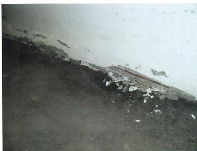
Skader på vegger
