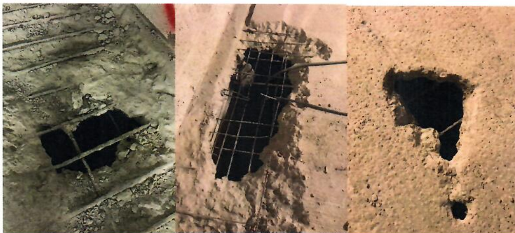
Hull i dekke og ødelagt armering
